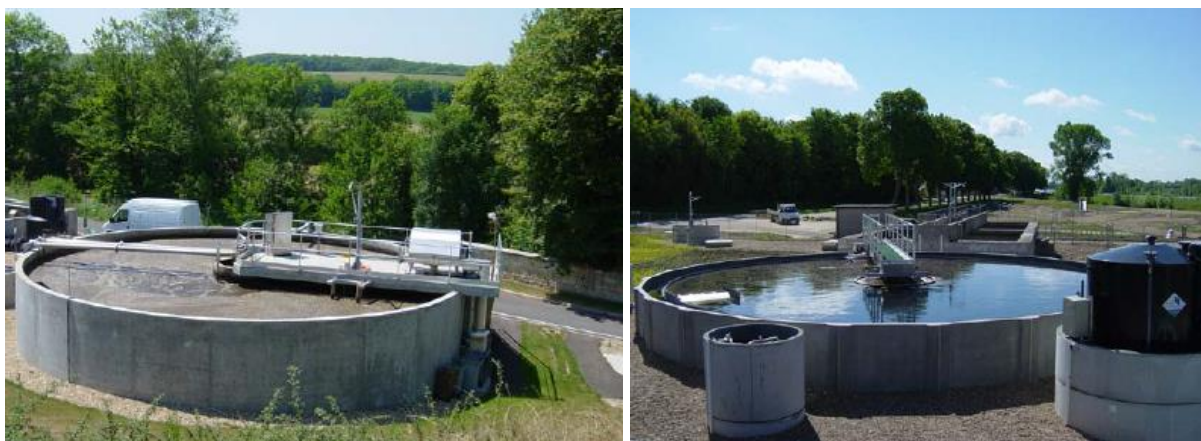
Bassin d'aération (à gauche) et clarificateur (à droite)
